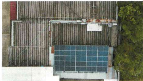
Ilustración 30. Paneles solares oficinas administrativas.
