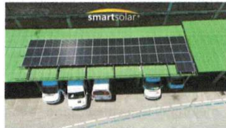
Gráfico 29. Paneles solares expendio pasajeros Roldanillo.
